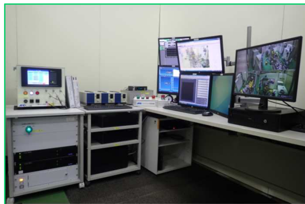
制御・計測盤
